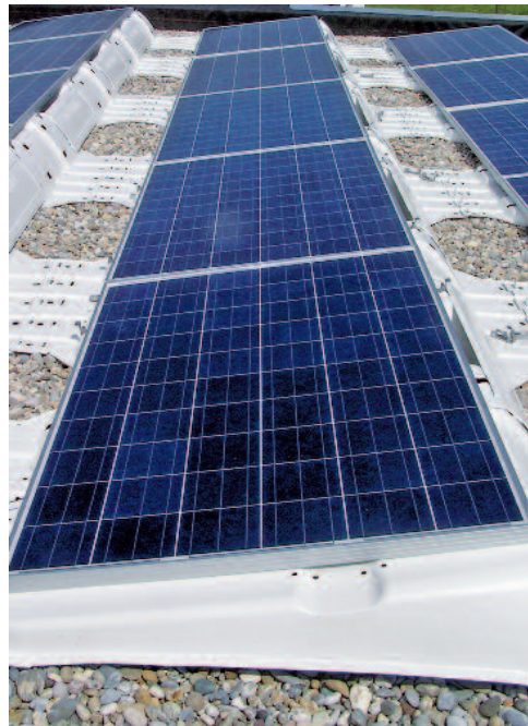
Tragkonstruktion aus organisch beschichtetem Zink-Magnesium-veredeltem Feiblech für Fotovoltaik-Elemente
