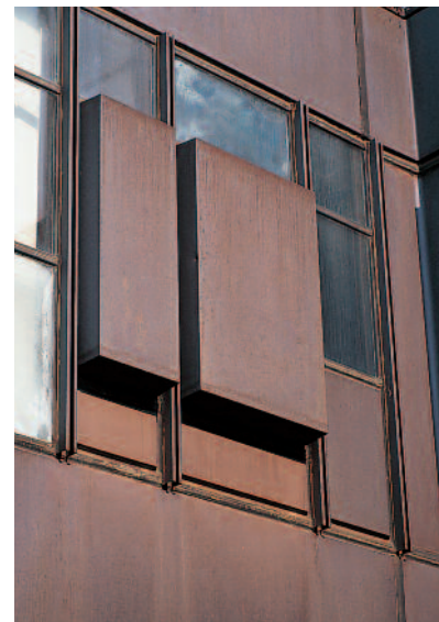
Abb. 4: Die Flächen, die direkt unter den beiden hervorstehenden Fassadenelementen liegen, weisen eine hellere Braunfärbung auf. Sie sind weitgehend nur indirekt benetzt.
