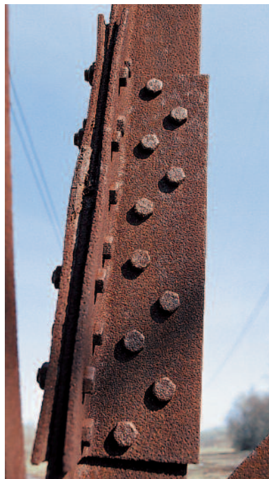
Abb. 11: Stoß des Winkels in einem Fachwerkmast. Zu große Schraubenabstände bewirken auftreibenden Rost.
